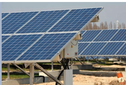
Freiflächen-Photovoltaikanlage der Gasag in Berlin-Mariendorf
